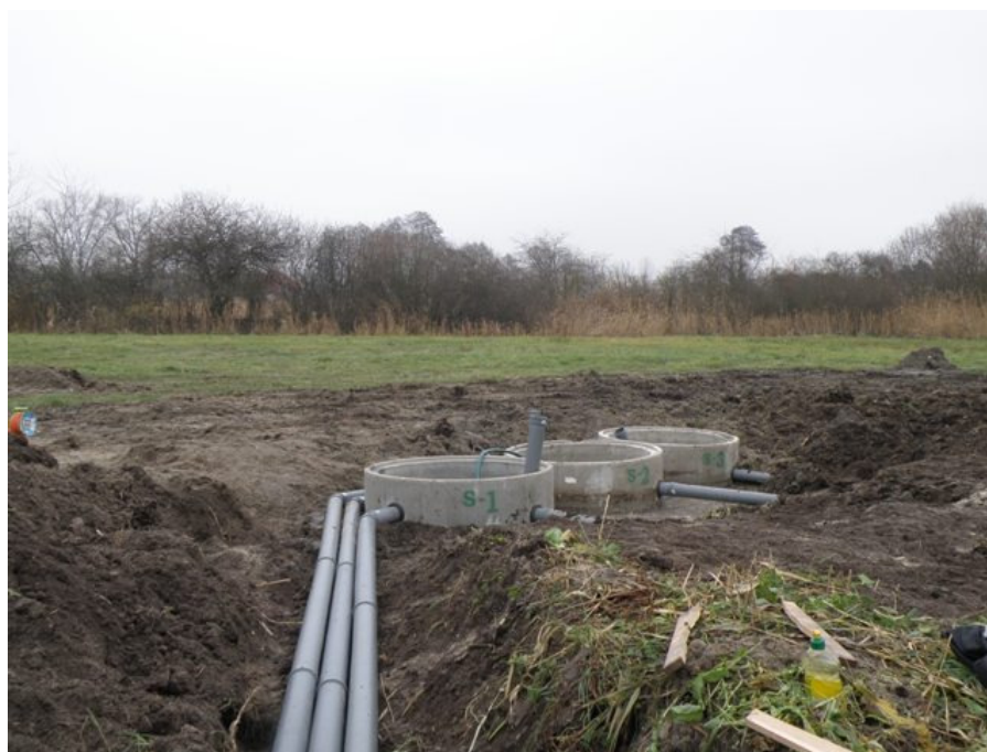
Figur 3: De tre polska filterbrunnarna sedan rördragningen färdigställts.
