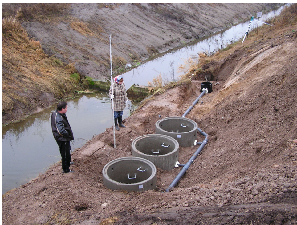
Figur 1: Den färdigställda litauiska anläggningen, dock ännu utan kalkfiltermaterial i brunnarna.
